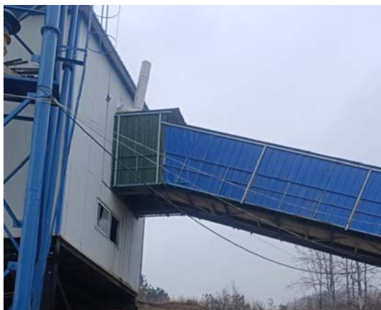
廊道密闭及搅拌机除尘器
