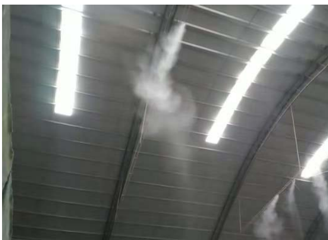
车间除尘装置
