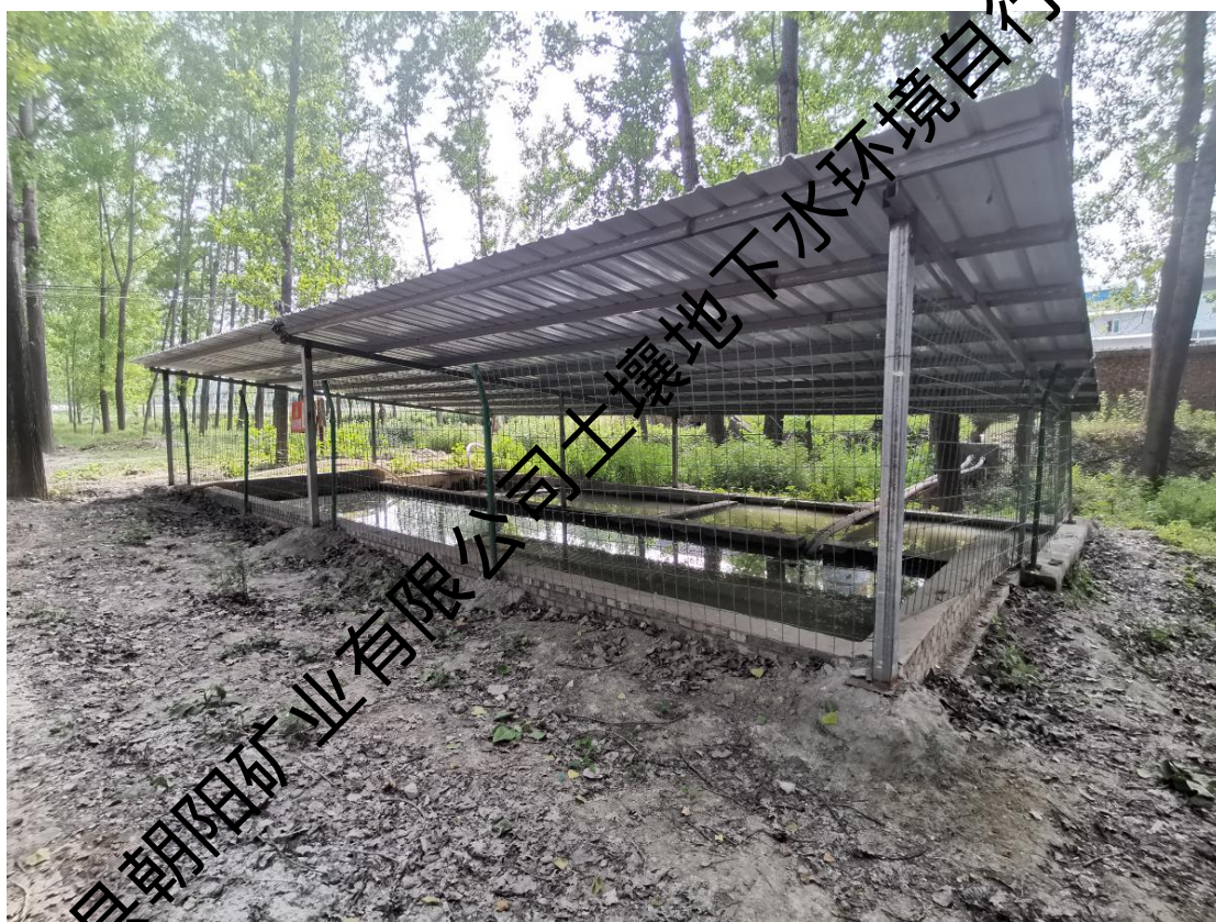
图4-6 废水治理设施(精矿渗滤液收集池)
