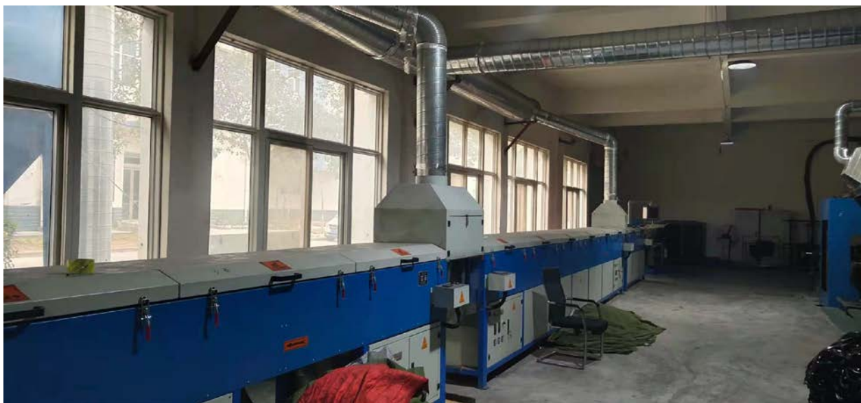
微波硫化设备整体封闭及集气罩设置情况
