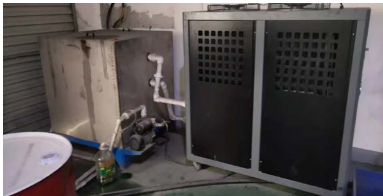
微波硫化生产线循环水箱
