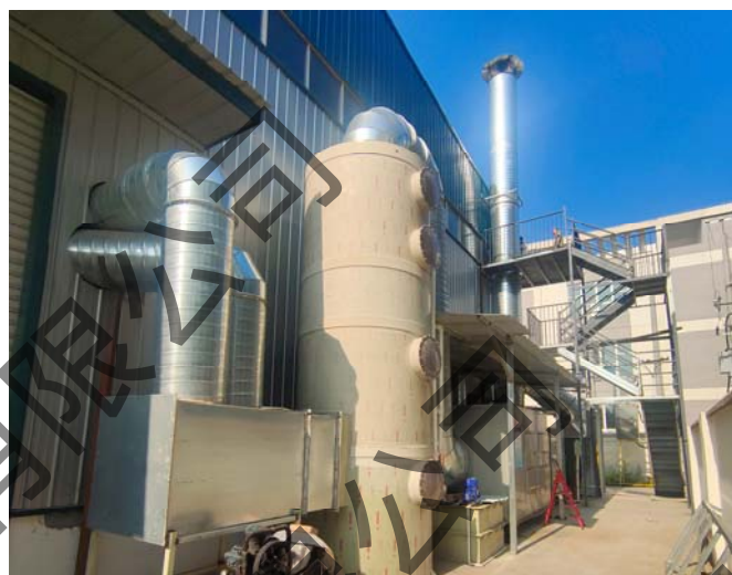
有机废气处理装置
