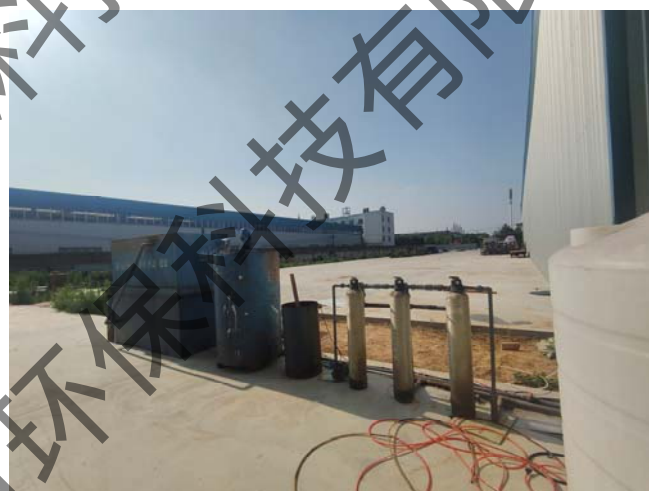
污水处理设施
