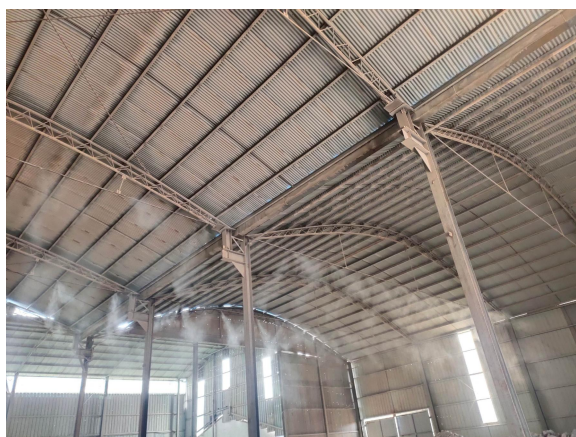
原料区喷干雾装置
