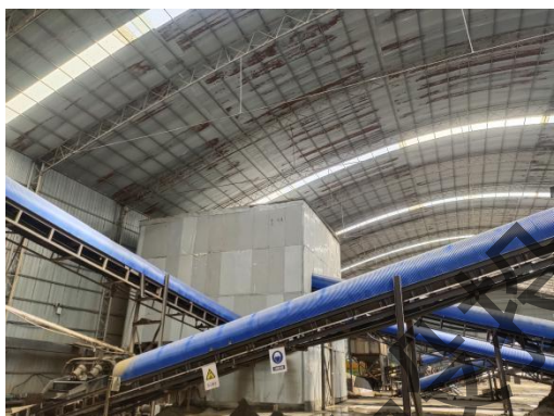
皮带及设备封闭
