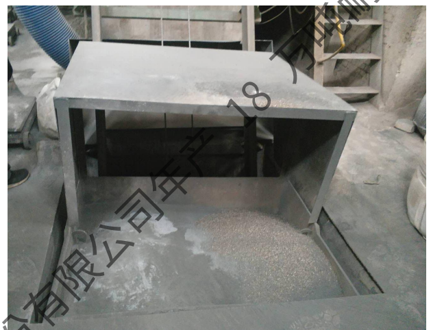
不定型分厂上料斗粉尘收集措施
