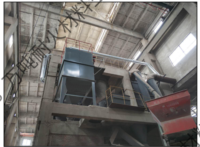
不定型分厂混料工序除尘器
