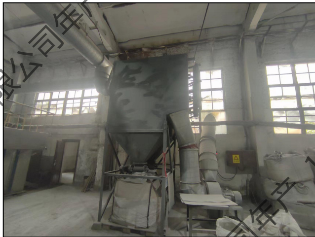
新材料分厂混料工序除尘器
