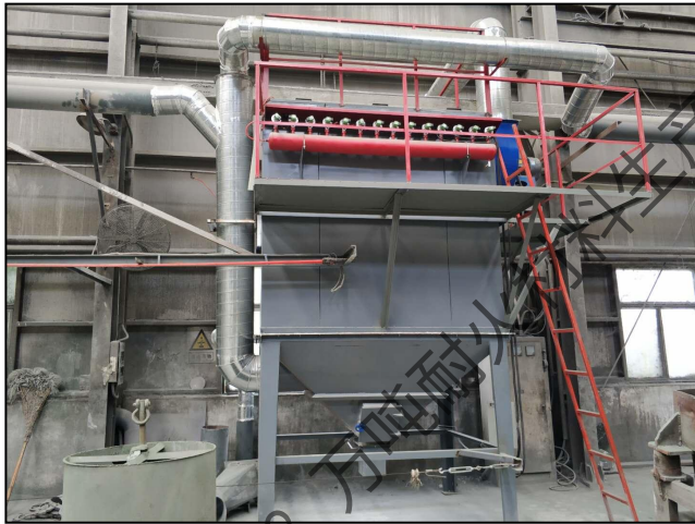
新材料分厂混料工序除尘器
