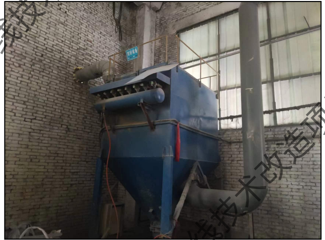
新材料分厂混料工序除尘器
