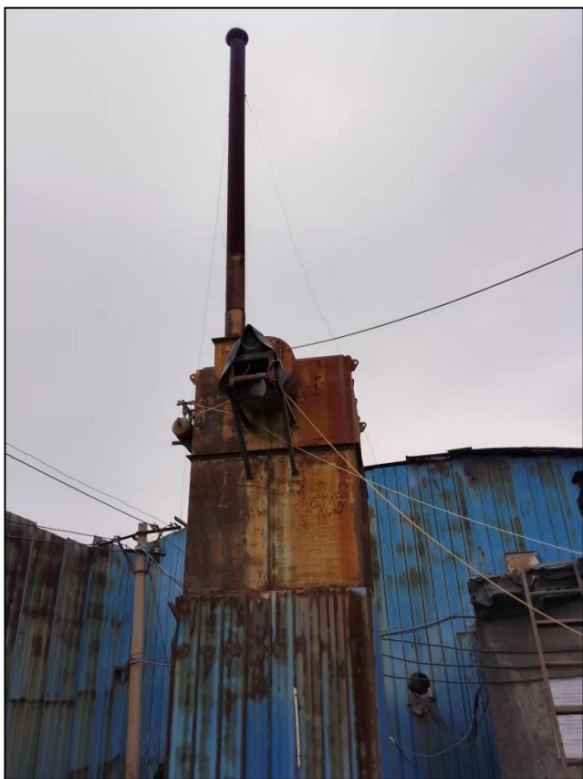
筛分除尘器及排气筒
