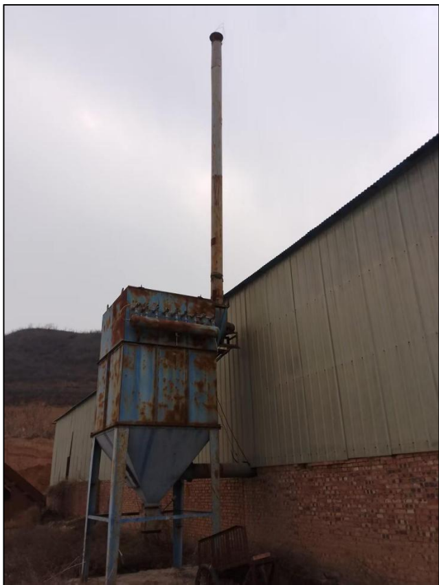
破碎除尘器及排气筒
