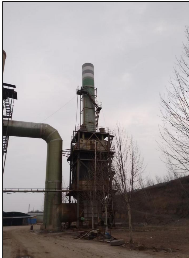
隧道窑工序环保设备及排气筒
