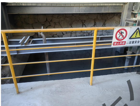
车间内事故池
