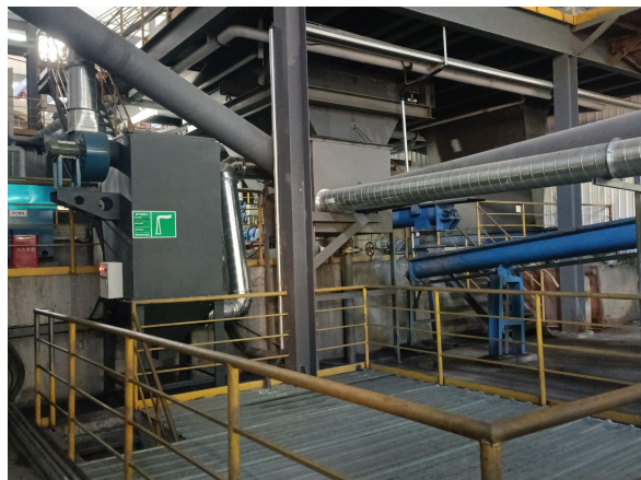
包装工序覆膜袋式除尘器
