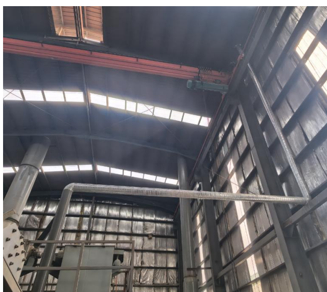
矿粉仓除尘器+排气筒
