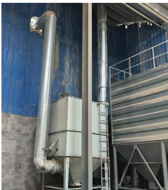
再生料破碎筛分、供应工序除尘器+排气筒
