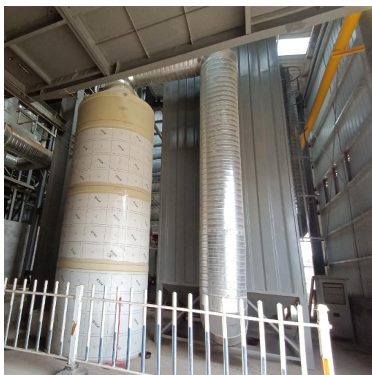
沥青废气喷淋塔+电捕焦油器
