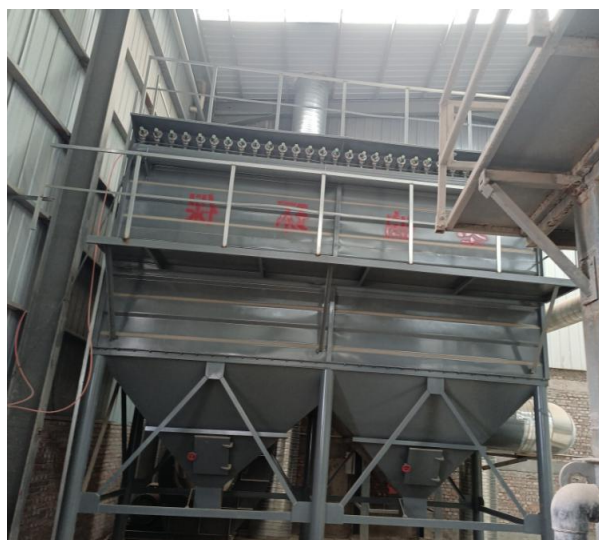
石子、石屑输送带转接粉尘除尘器+排气筒
