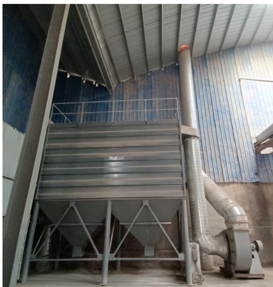
骨料下料、输送带转接粉尘除尘器+排气筒
