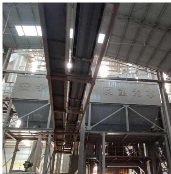
骨料干燥筛选、沥青废气除尘器
