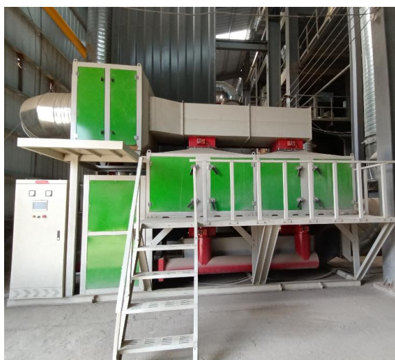
沥青废气活性炭+催化燃烧装置
