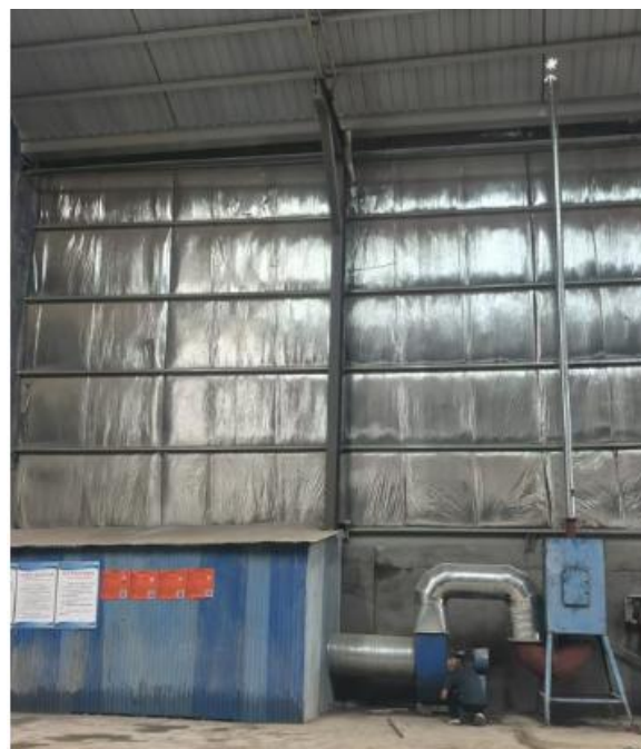
危废贮存库活性炭装置+排气筒
