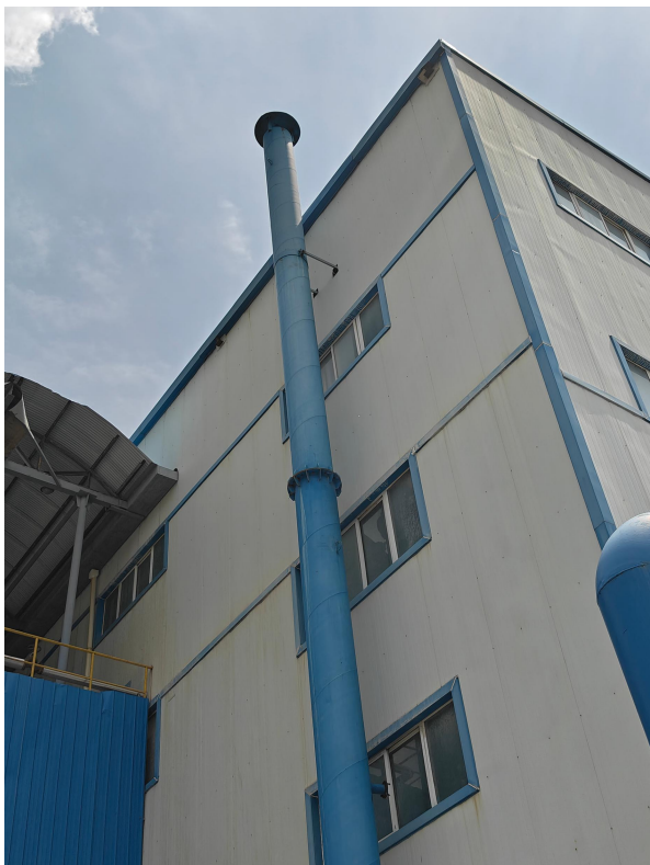
浮选废气处理设施排气筒
